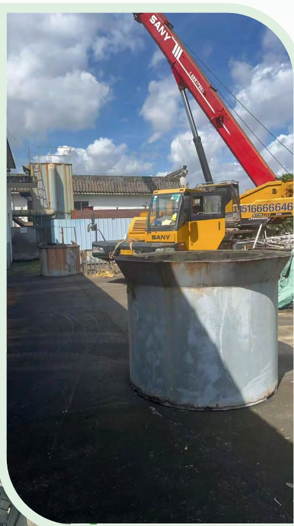
◇ 深粮食品公司在锅炉房废气排放口安装脱硝系统
